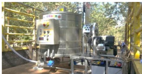
ภาพที่ 3-2 เครื่องสัดน้ำฝ้งแบบอัตโนมัติที่ได้ดำเนินการเสร็จสมบูรณ์
